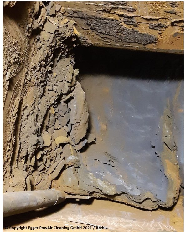
Vor der Reinigung durch Egger PowAir Cleaner Ablagerungen bis 1.20 Meter Dicke (Bild 2)
