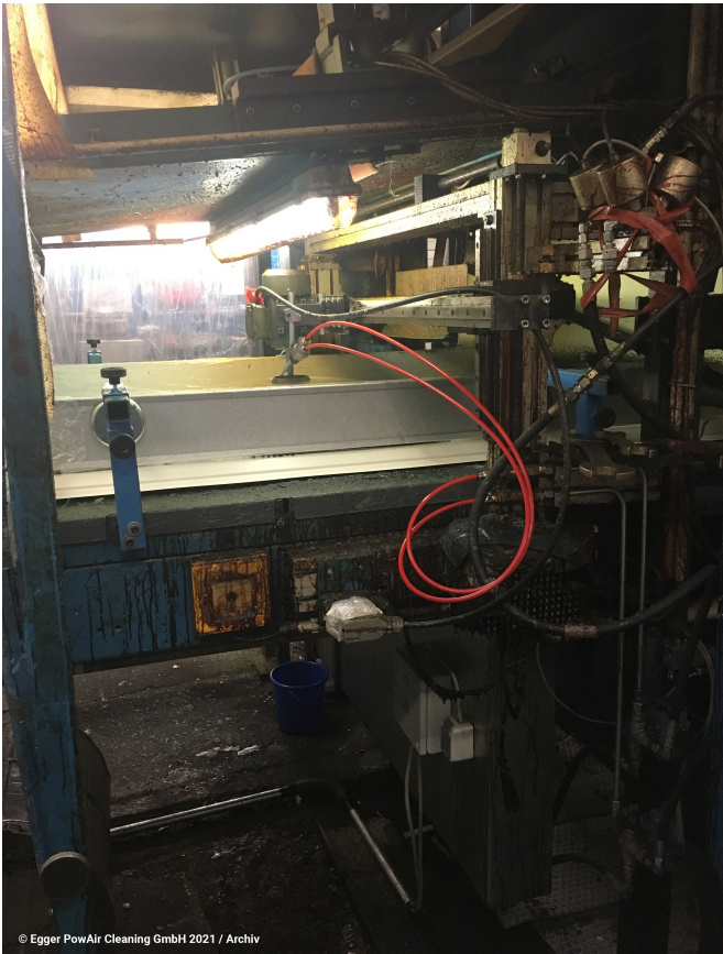
Im laufenden Betrieb wurde diese Produktionsanlage mit kalter Trocken-Druckluft und sonst nichts... gereinigt. Das KDL-Verfahren ist der Industriestandard für berührungslose Reinigung von Industrieanlagen in ganz Europa.
