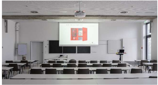
Hörsaal 1: Projektor, motorisch ausfahrbare 3,5 x 2,19 m Decken-einbau-Leinwand, Mikrofon- und Lautsprecheranlage
